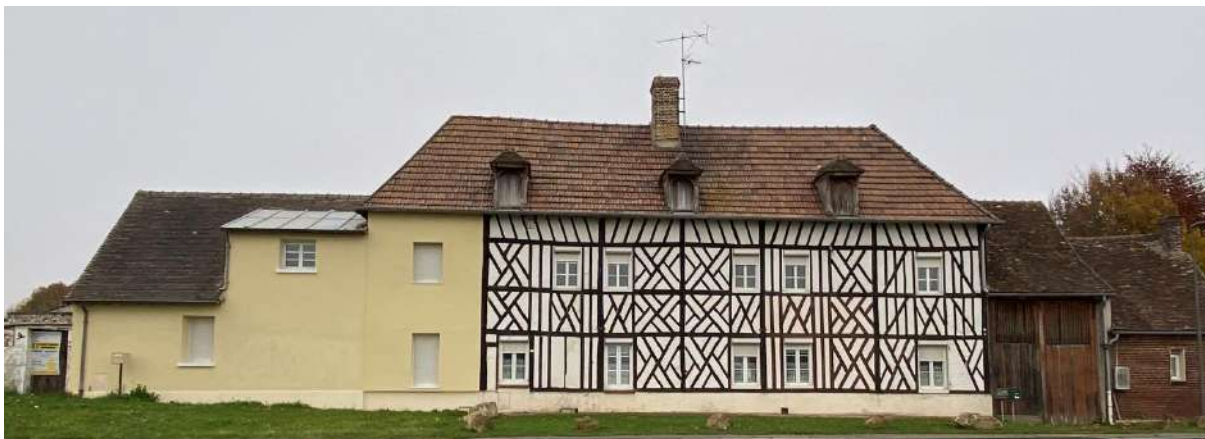
Maison à colombages menacée par une isolation par l'extérieur (Oise – Maisons Paysannes)
